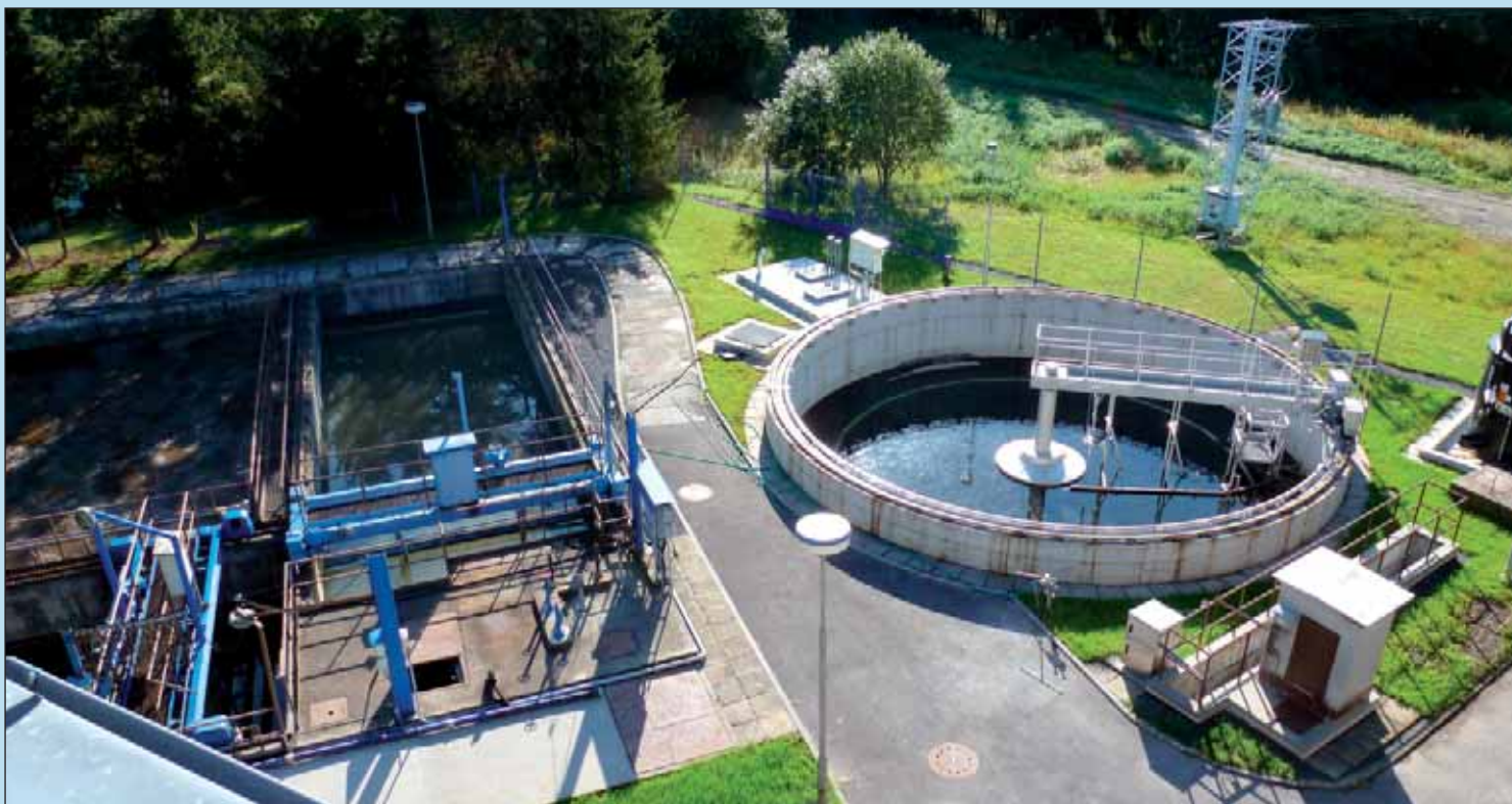
◀ Čistírna odpadních vod města Vítkov je umístěna na horním toku potoka Černná.
