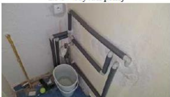
2.NP - spiž, rozvody vody na pračku
