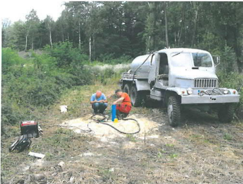
Obrázek č.14: plocha D - záběr z realizace nálevové zkoušky na vrtu NBN-10.
